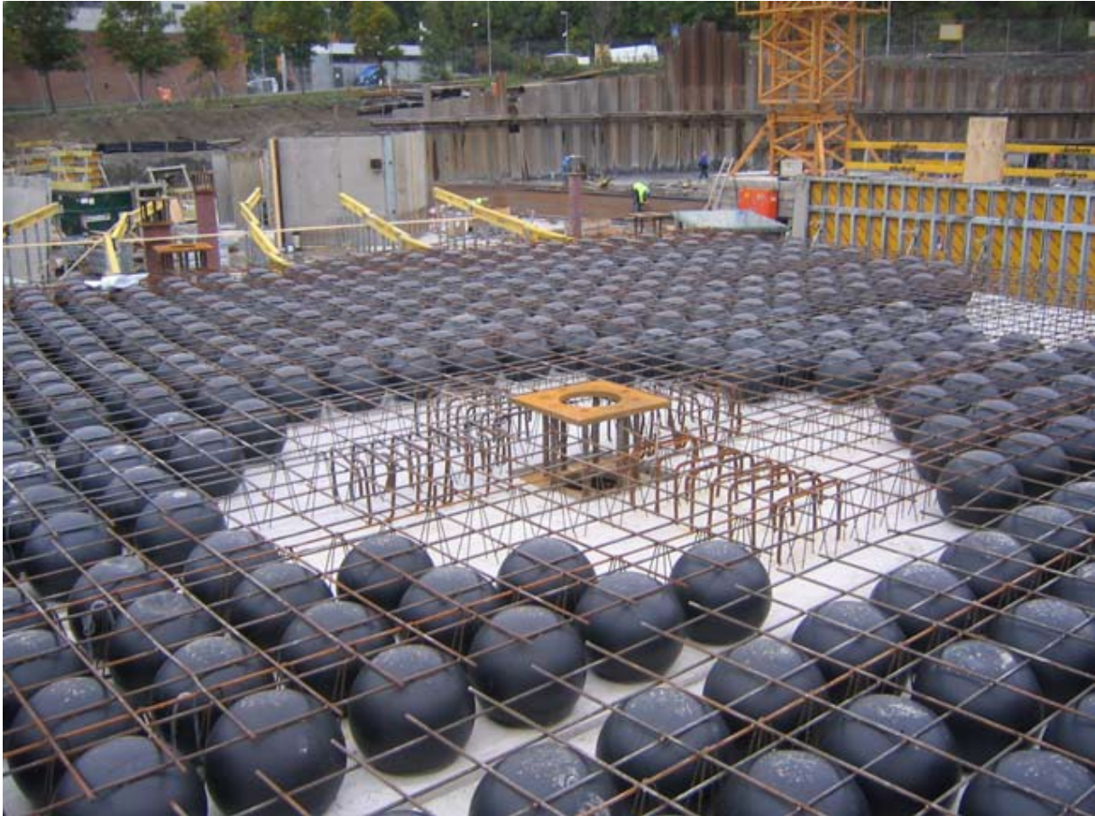
Figur A6 Fra byggeplass. Detalj ved søyler. I soner med konsentrerte laster (som ved søyler) anbefales det i søylenes umiddelbare nærhet å fjerne boblene og erstatte dem med fulltverrsnitt. Kontroll av gjennomlokking utføres derfor som ved fulltverrsnitt.
