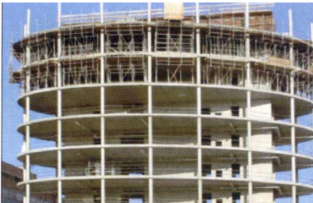
Figur A1 Dekkesystemet har fordeler som lav egenvekt, redusert materialforbruk og stor bæreevne i forhold til vekt.
